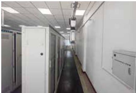
轨道机器人巡检
