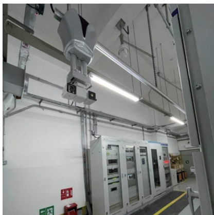
S型轨道机器人巡检
